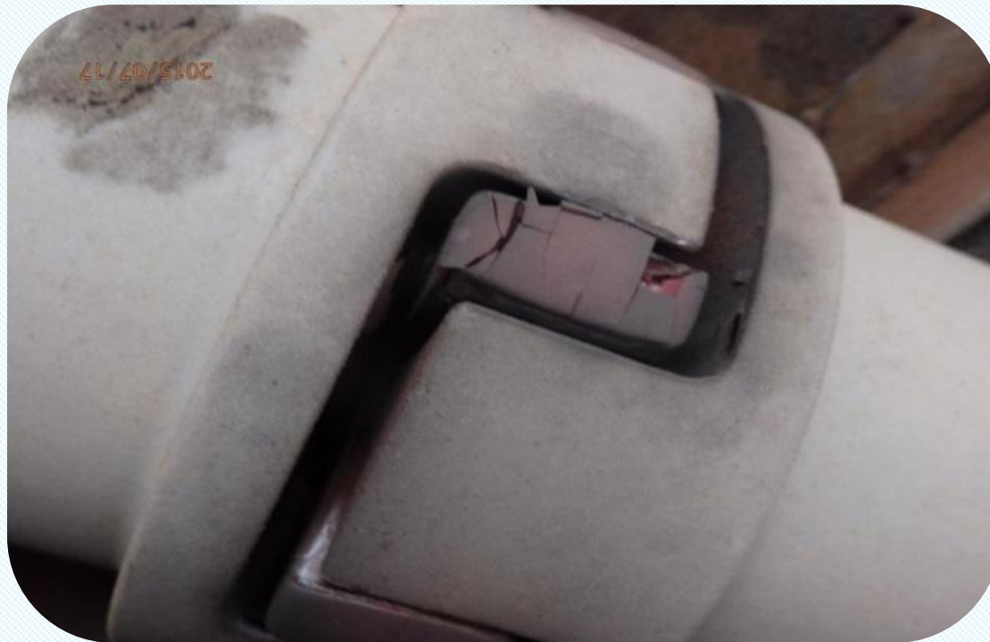
起升机构联轴器梅花垫磨损，破碎
