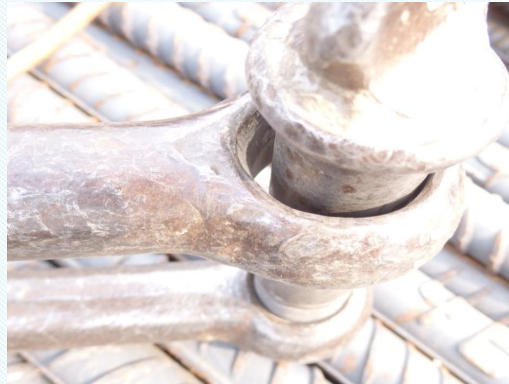
卸扣磨损，封闭销与孔间隙过大
