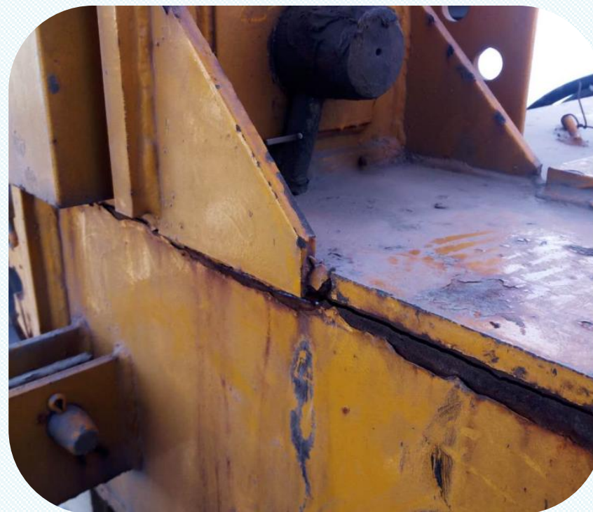
回转支撑横向焊缝开焊
