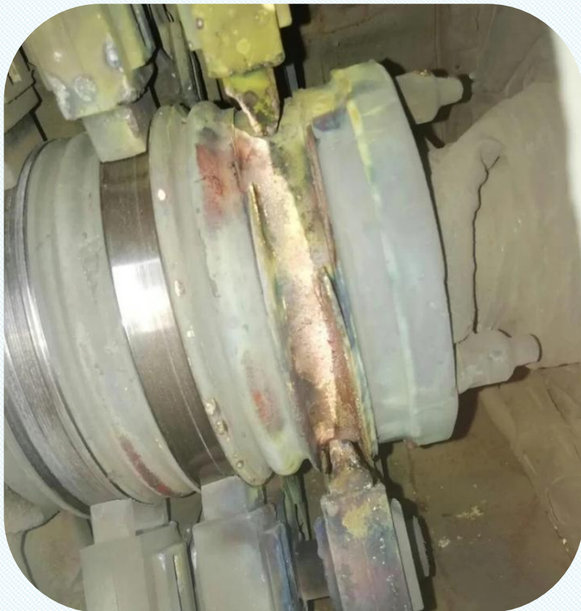
起升电机滑环磨损严重
