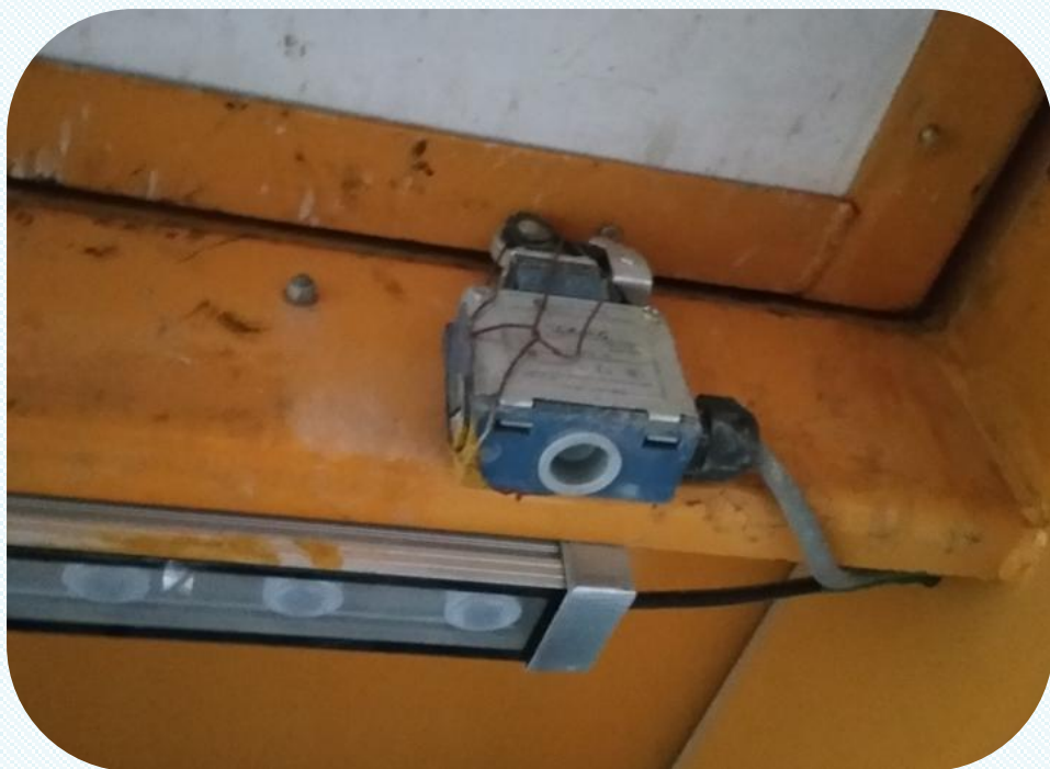
天窗限位绑扎失效
