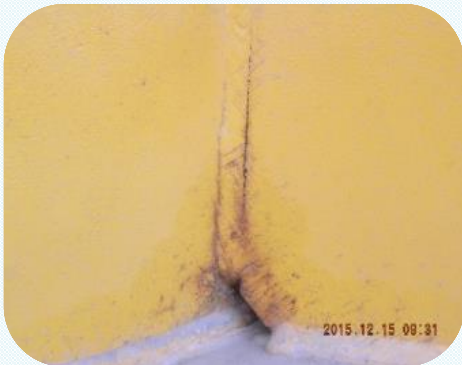
回转支撑竖向焊缝开焊
