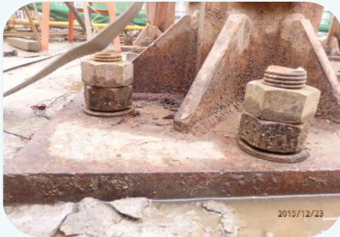
基础地脚螺栓松动，底座晃动
